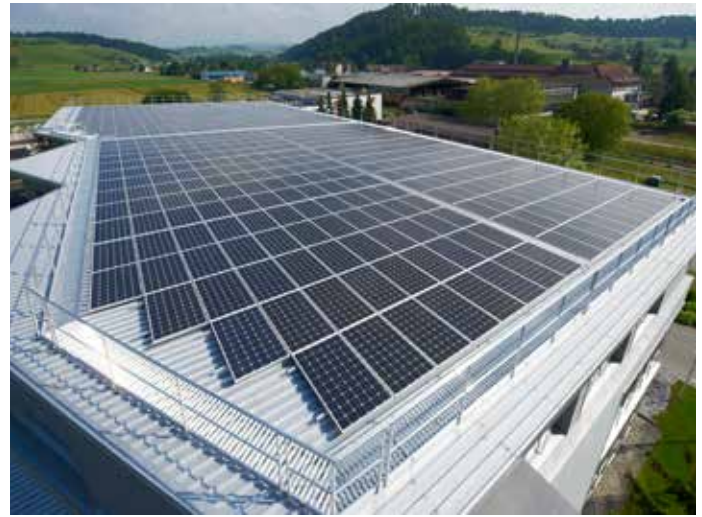
PV-Anlage mit 162 KWh Leistung.
